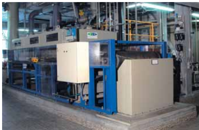
Abb. 7 Flugaschewäsche in der KVA Trimmis.
