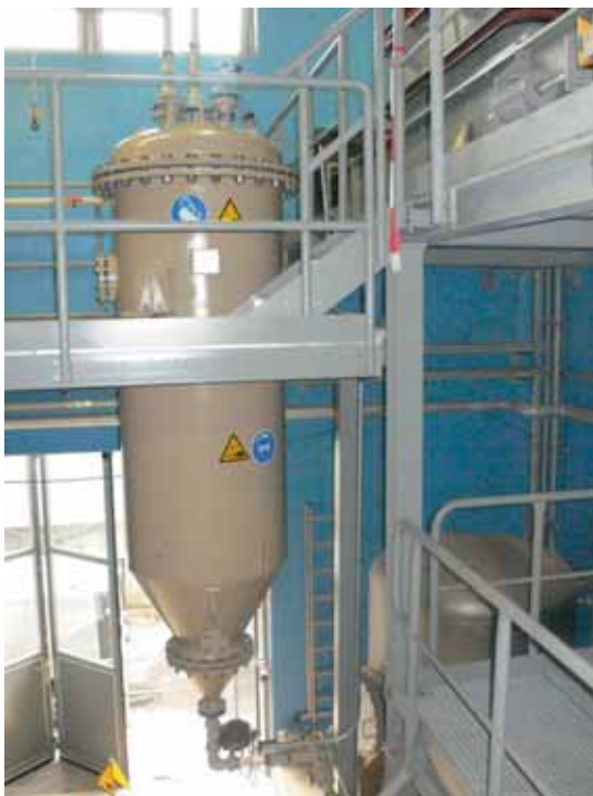
Abb. 4 Kerzenfilter für die Vorfiltration in der KVA Limmattal (CH)
