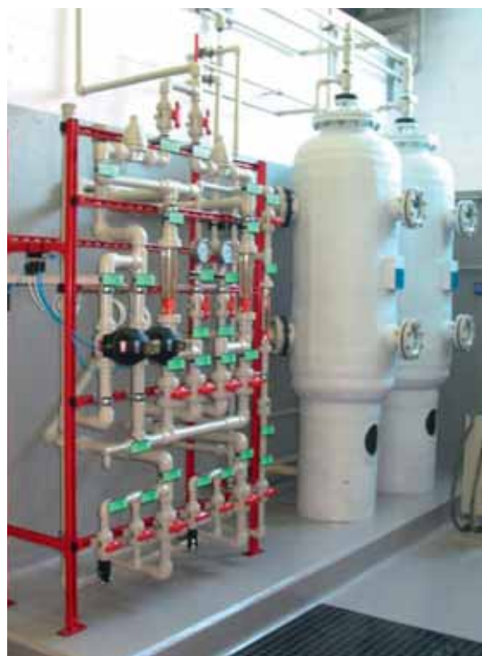
Abb. 5 Ionentauscherkolonnen für die Quecksilberabscheidung in der KVA Niederurnen (CH)
